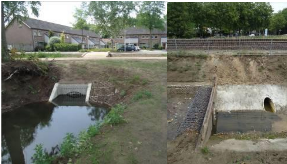
Figure 5-3: links uitstroom rwa put 1 en rechts stuw (influent links, effluent na lavafilter rechts)
