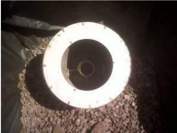
Figuur 26 Drainage put. Deze heeft een buitendiameter van 600 mm. Daarin is een cilinder geplaatst met een diameter van 400 mm waardoor een korf ontstaat met een breedte van 100 mm. De korf is in de foto afgedicht met een metalen plaat. Het gewenste filtersubstraat, in dit geval actief kool, wordt in de korf geplaatst. Actief kool heeft een lagere doorlatendheid dan lava waardoor het drainerende vermogen van de voorziening lager is dan het infiltrerende vermogen. Hierdoor zal de voorziening behalve als zuivering ook als buffer fungeren.
